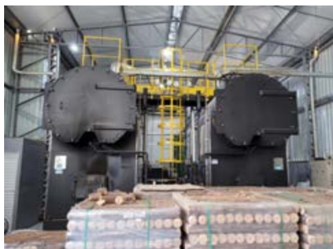
Caldeiras de Produção de Vapor e Água Quente
