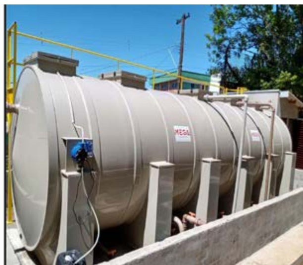
Estação de Tratamento de Efluentes do Hospital São Roque
